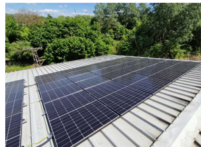
Fotografie č. 9: Fotovoltaika na střeše firmy AGC v Nesovicích
