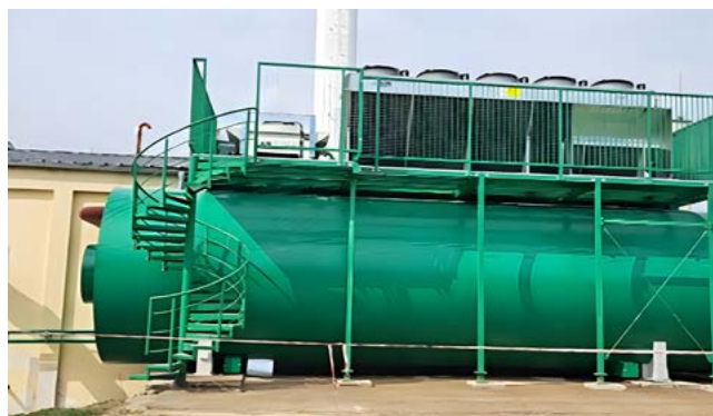
Fotografie č. 11: Kogenerační jednotka pro Teplospol Jindřichův Hradec – 999 kWe
