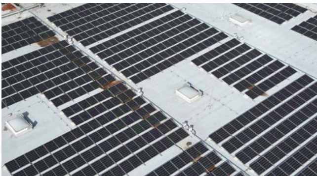
Fotografie č. 7: Jedna z fotovoltaických elektráren, které jsme instalovali na střechách budov Globus
