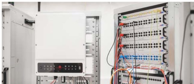
Fotografie č. 5 : Testování střídačů v naší Laboratoři čisté energetiky
